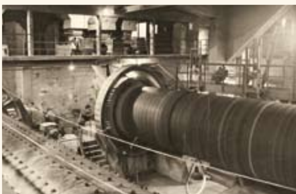
Cementová mlýnice Závodu III s mlýny č. 9 a č. 10
