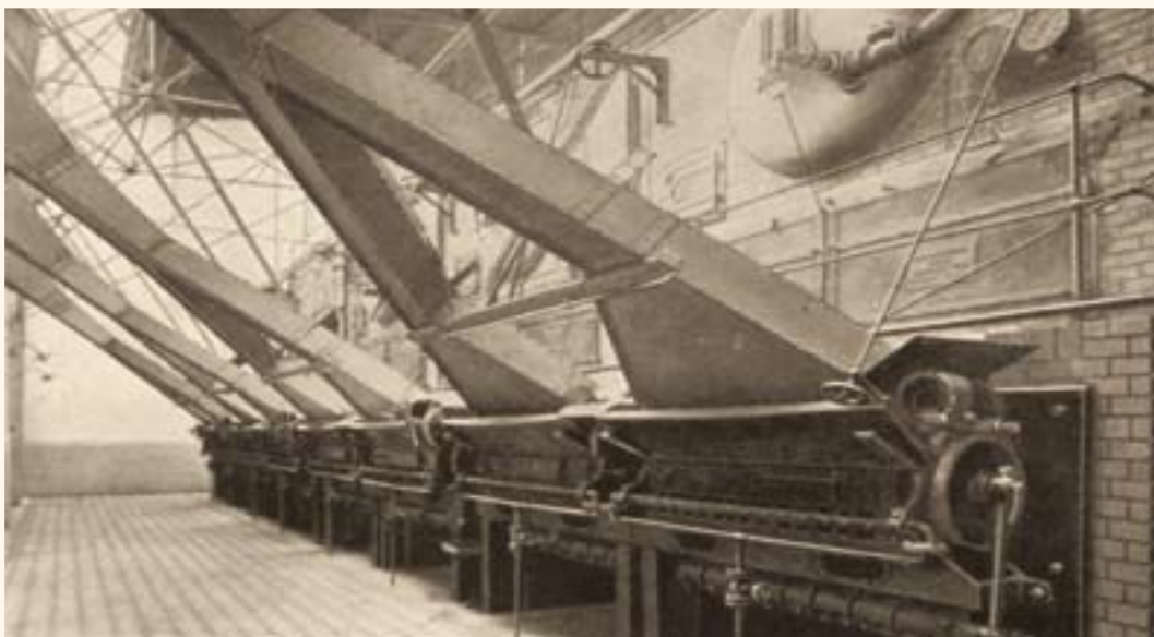
Kotelna s uhelnými násypkami k roštům, 1911
